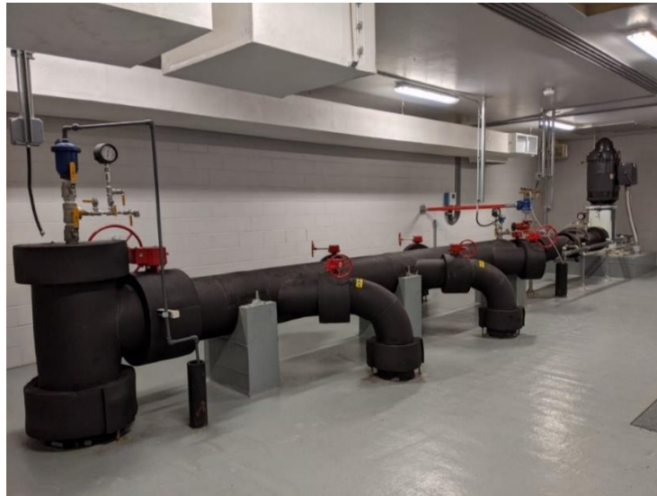
Figure 3 : Conduite d'amenée dans le bâtiment du Puits P-3 - novembre 2020
