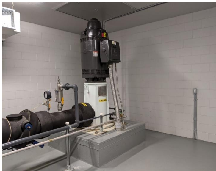
Figure 2 : Photo des installations de prélèvement du puits P-3 - novembre 2020
