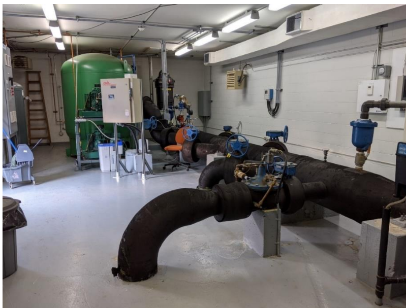
Figure 6 : Conduite d'amenée dans le bâtiment du Puits P-5 – novembre 2020
