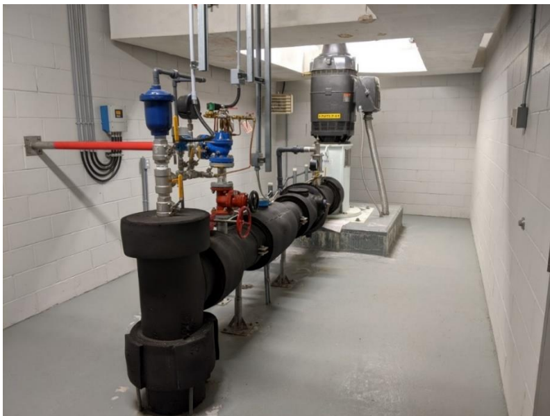
Figure 5 : Puits P-4 – novembre 2020
